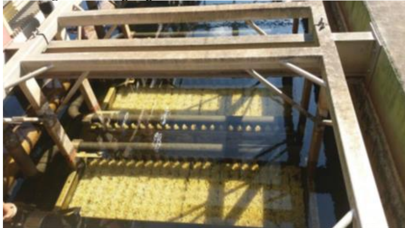
Abbildung 18: Reinigung der Membranen im Rahmen der Wartung
