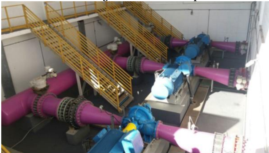
Abbildung 20: Station mit Pumpen
